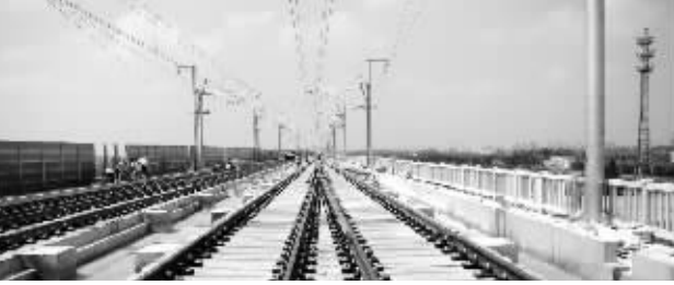
●沪杭客专高铁新型42号道岔板。
