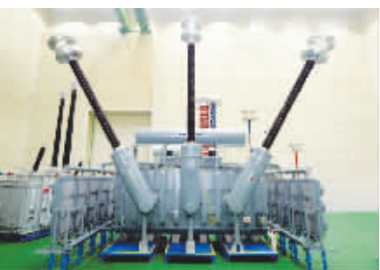
750kV级世界最大容量的1230MVA现场组装式发电机变压器在特变电工衡变研制成功。
