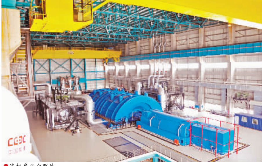
汽机房平台照片
