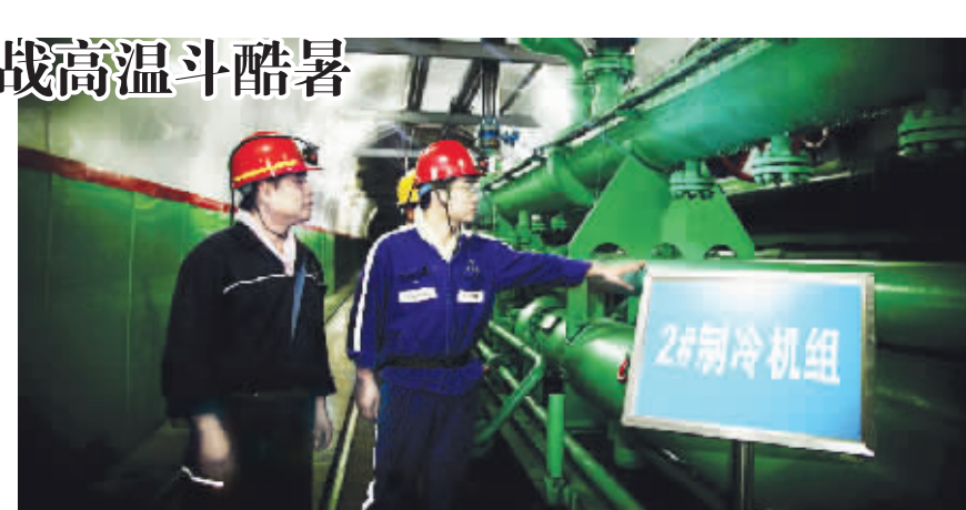
该矿人员正在认真巡检井下制冷机组,保证设备完好运行。
