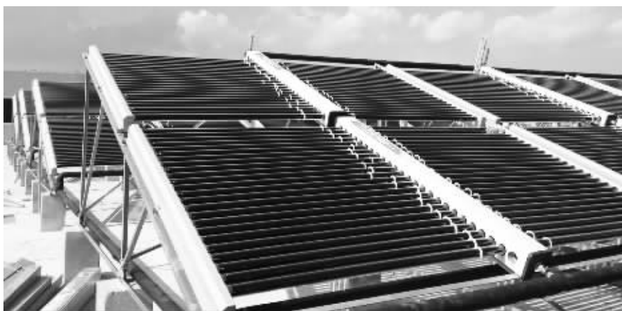
●康奈集团即将竣工的公寓楼已经安装上太阳能热水器
