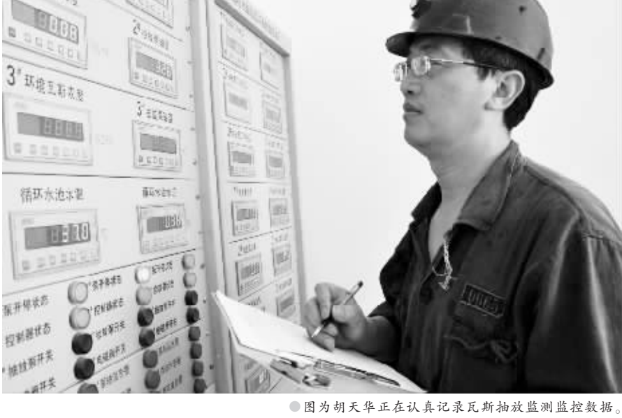
●图为胡天华正在认真记录瓦斯抽放监测监控数据。
