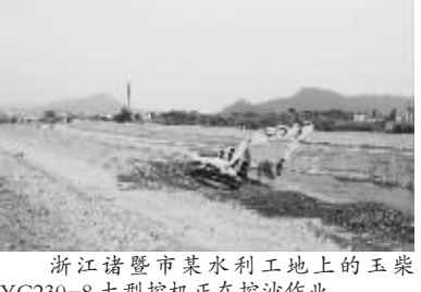
浙江诸暨市某水利工地上的玉柴YC230-8大型挖机正在挖沙作业。
