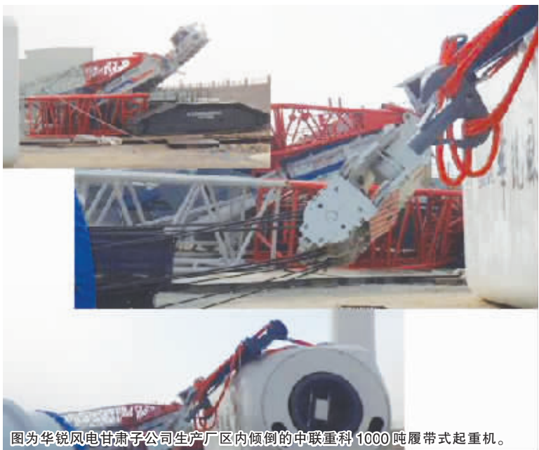
图为华锐风电甘肃子公司生产厂区内倾倒的中联重科 1000 吨履带式起重机。
