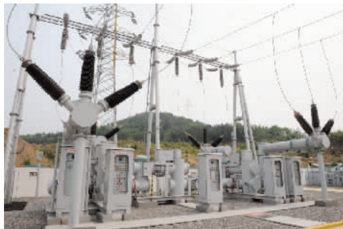
绵阳110千伏永昌变电站是“5·12”地震灾后重建的首个智能变电站
