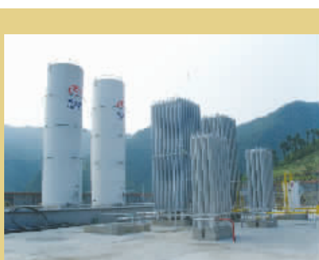
◎巨能公司 万源公司 LNG接收站(左:液化天然气低温储罐;右:空温式气化器)
