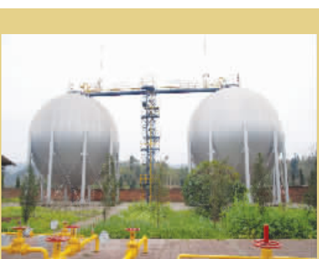
◎巨能公司达县天然气有限公司储气罐
