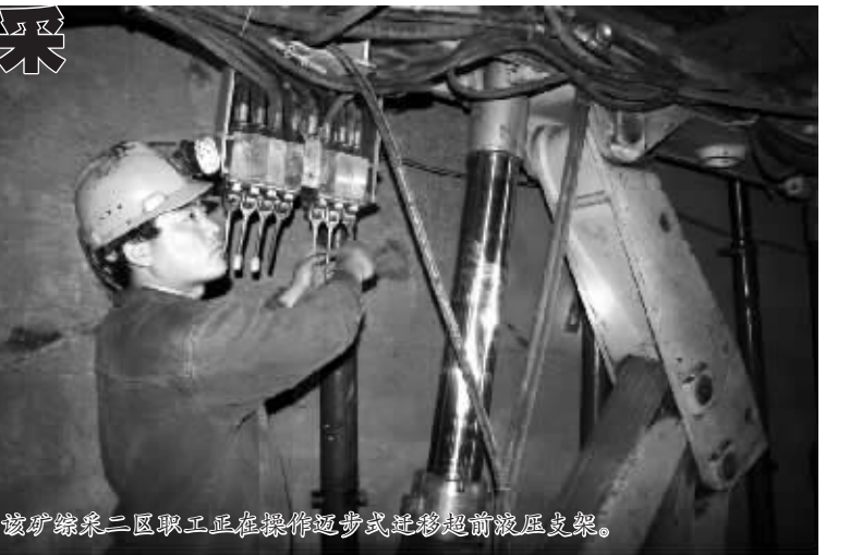
该矿综采二区职工正在操作迈步式迁移超前液压支架。
