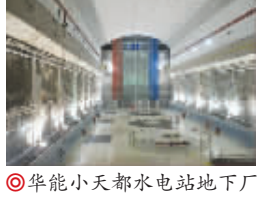
华能小天都水电站地下厂房
