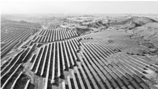
● 位于宁夏中卫市腾格里沙漠边缘的大唐中卫云基地数据中心绿电供应200万千瓦新能源项目(2026年2月10日摄)。
