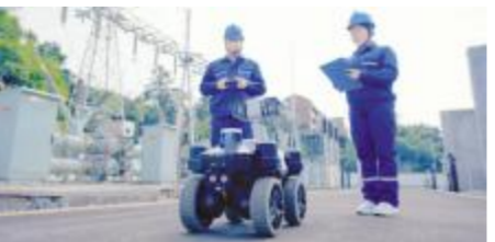
●四川能投发展综合运用新技术开展设备巡检。
