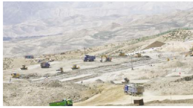
● 图为航拍中国西部装机容量最大的抽水蓄能电站——青海哇让抽水蓄能电站施工现场。(无人机照片)
