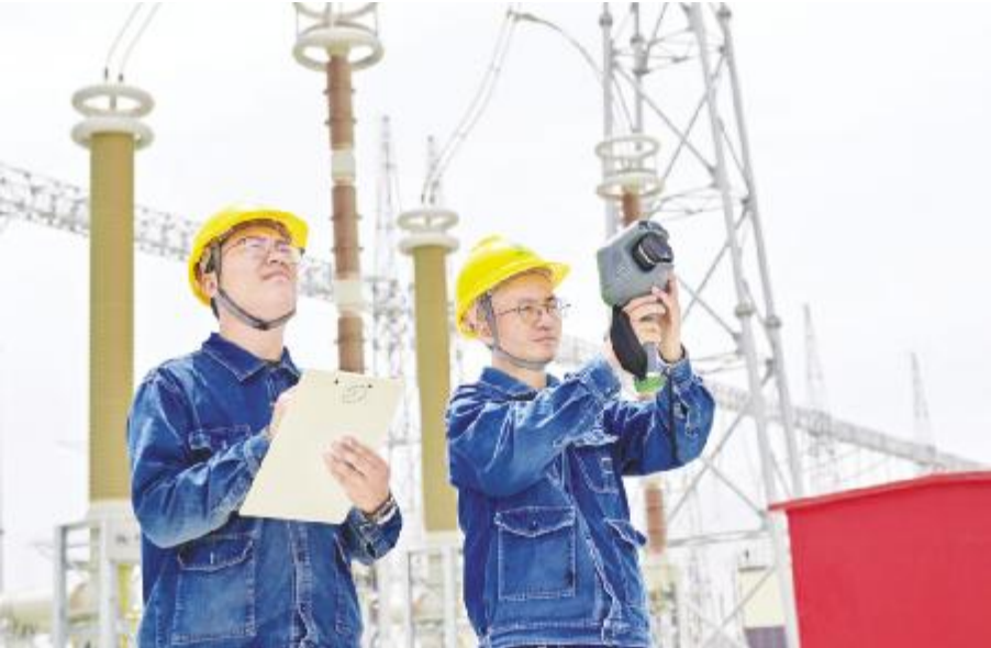
●在新疆环塔里木盆地750千伏输变电工程若羌750千伏变电站，运检人员检测设备温度。丁磊 摄
