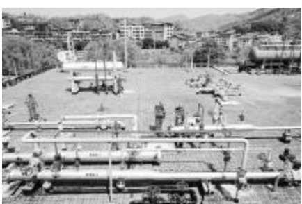
●图为员工在设备区进行维护保养。
