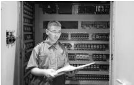
● 防务事业部设备维修中心的维修电工王帅
