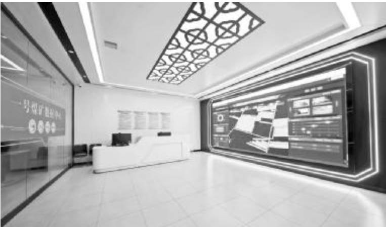
●一号煤矿 AI+NOSA 智能风险管控系统监控中心
