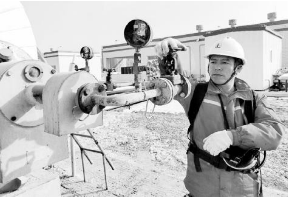
● 生产运行主管黄华辉在检查 6—1 计转站加热炉运行情况。
