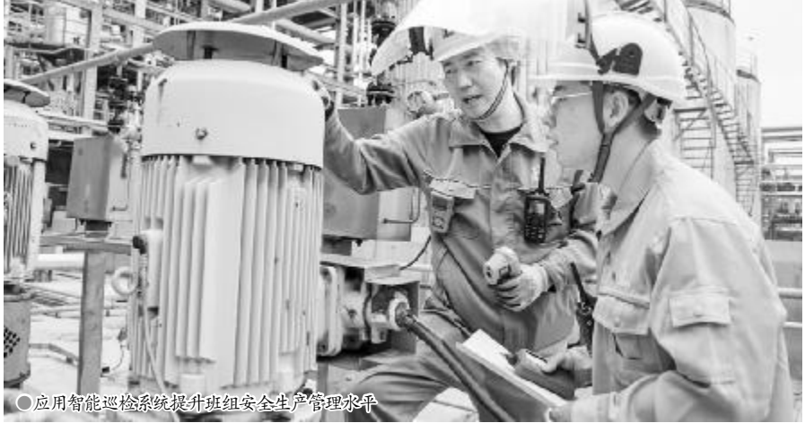
●应用智能巡检系统提升班组安全生产管理水平
