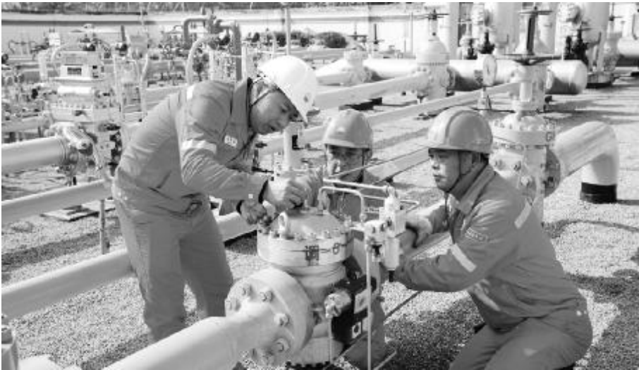
●管理人员与中心站员工处理供气故障。
