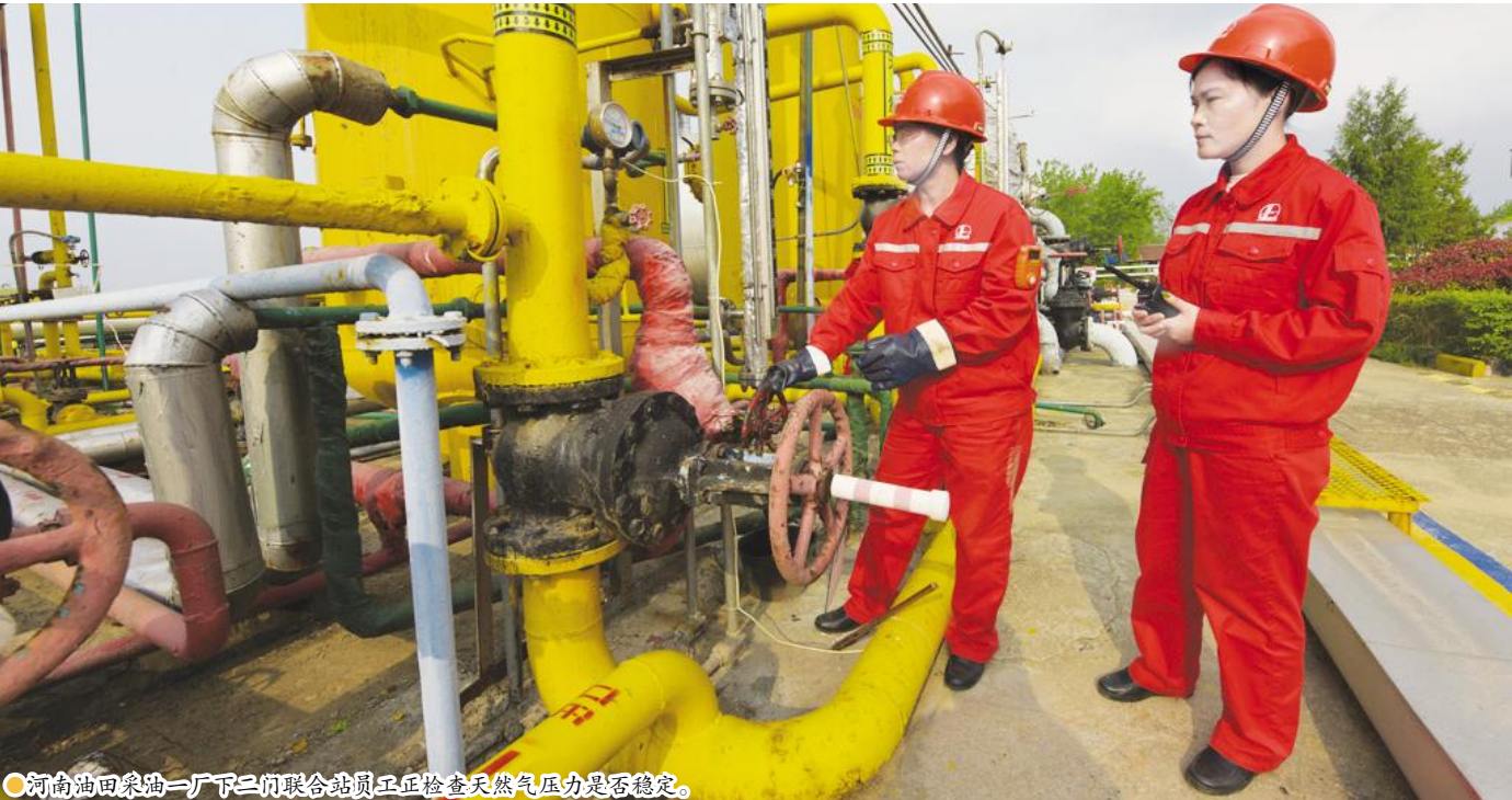
●河南油田采油一厂下二门联合站员工正在检查天然气压力是否稳定。
