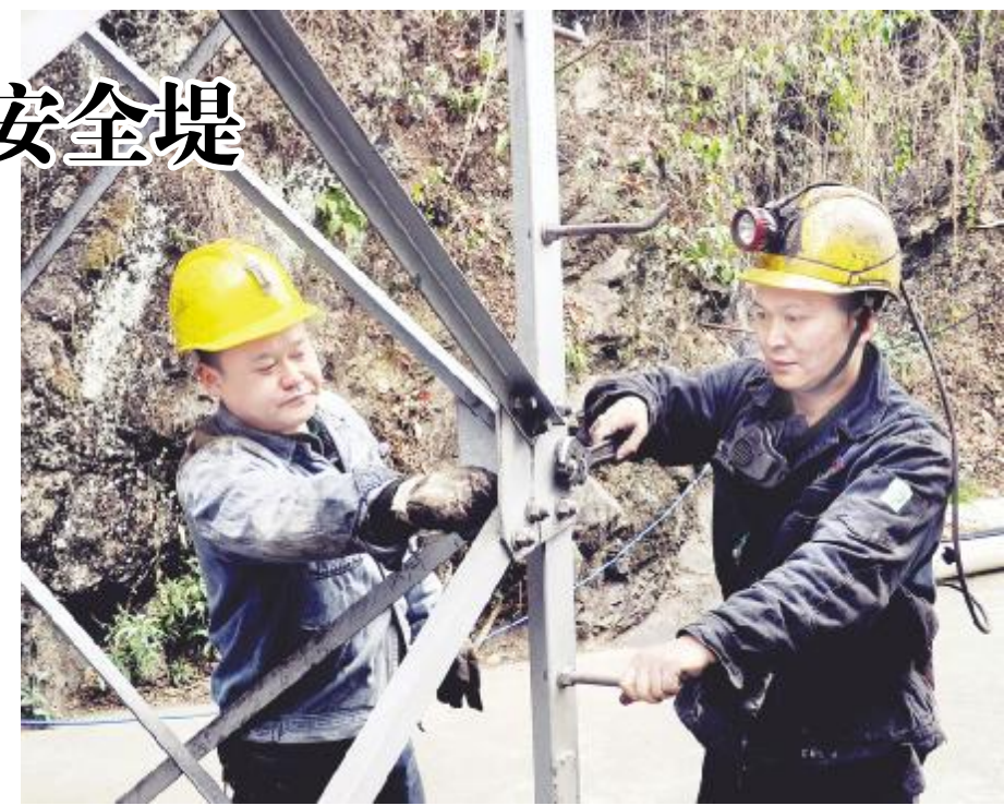
●员工在巡检检查避雷装置。
