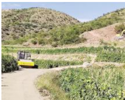
●修建一新的乡村公路
