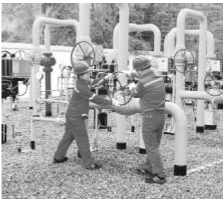
图为集中巡检班冒雨在杨家坝阀室检查保养设备。
