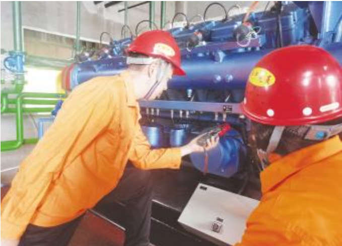
● 四方电力公司工作人员正在巡检瓦斯发电机组运行情况。
