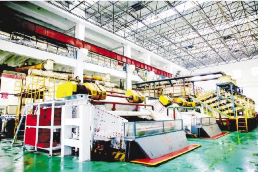
●李楼煤业选煤厂场景
