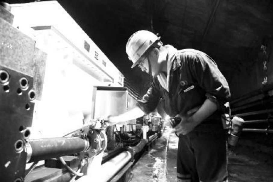
● 图为巡检工检查乳化液泵站
