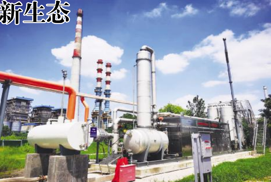
●南京港码头油气回收装置
