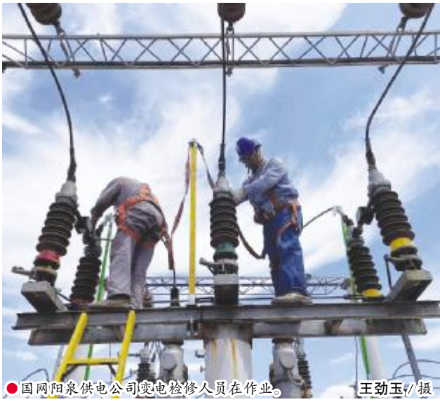
● 国网阳泉供电公司变电检修人员在作业。
