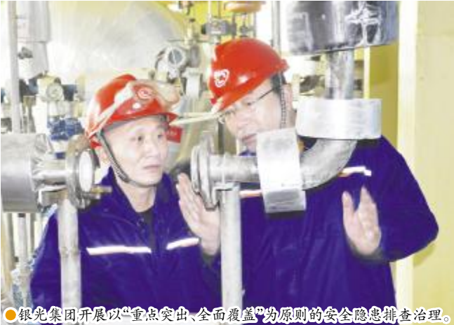
银光集团开展以“重点突出、全面覆盖”为原则的安全隐患排查治理。
