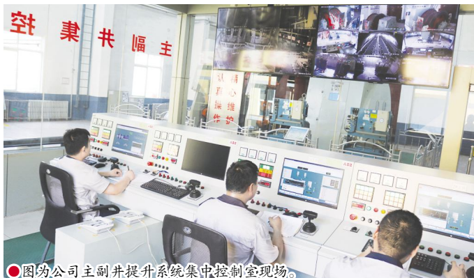
图为公司主副井提升系统集中控制室现场。
