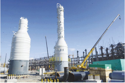
●已安装的不锈钢塔器
