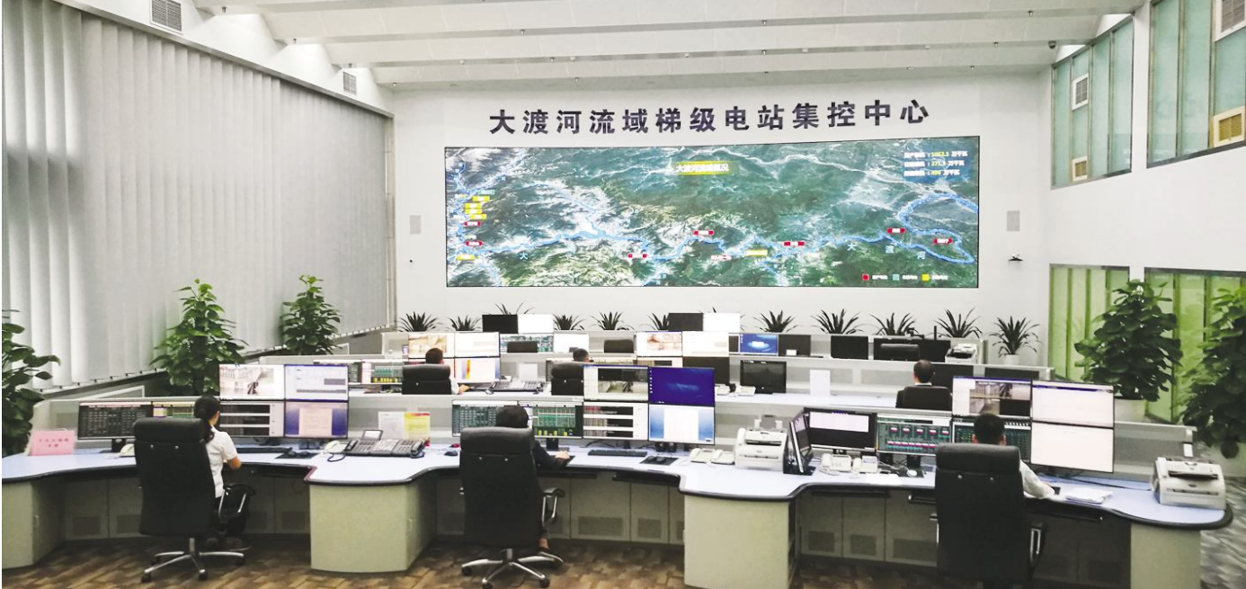
● 大渡河流域梯级水电站集控中心
