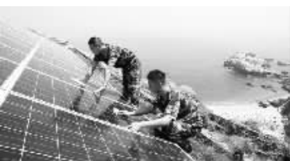
●光伏易达山岛 30KW 离网光伏发电项目，守岛官兵正擦拭光伏板
