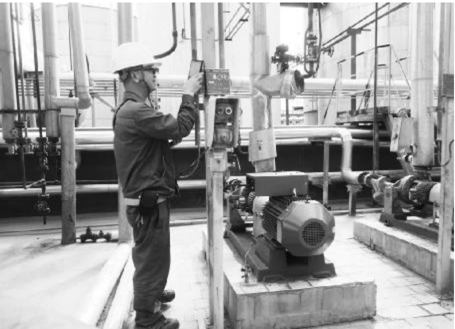
● 图为 9 月 16 日,员工利用巡检仪进行设备巡检打卡。
