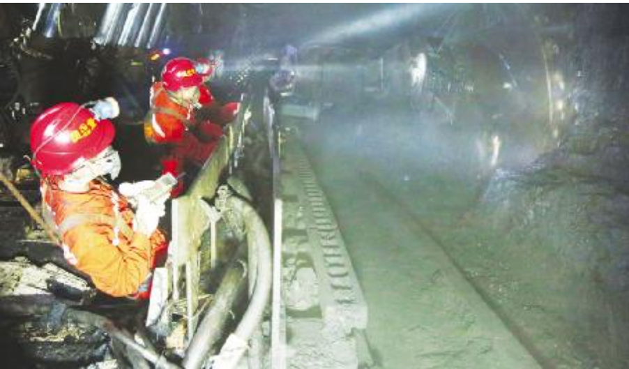
●在大倾角上遥控操作采煤机。
