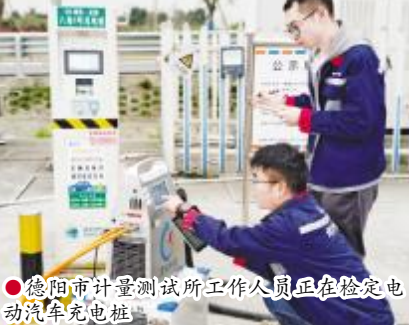
德阳市计量测试所工作人员正在检定电动汽车充电桩
