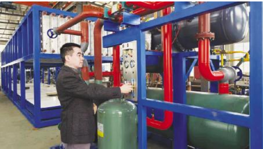
●在项目现场，于荣富对制冷设备运行的技术指标进行查验。
