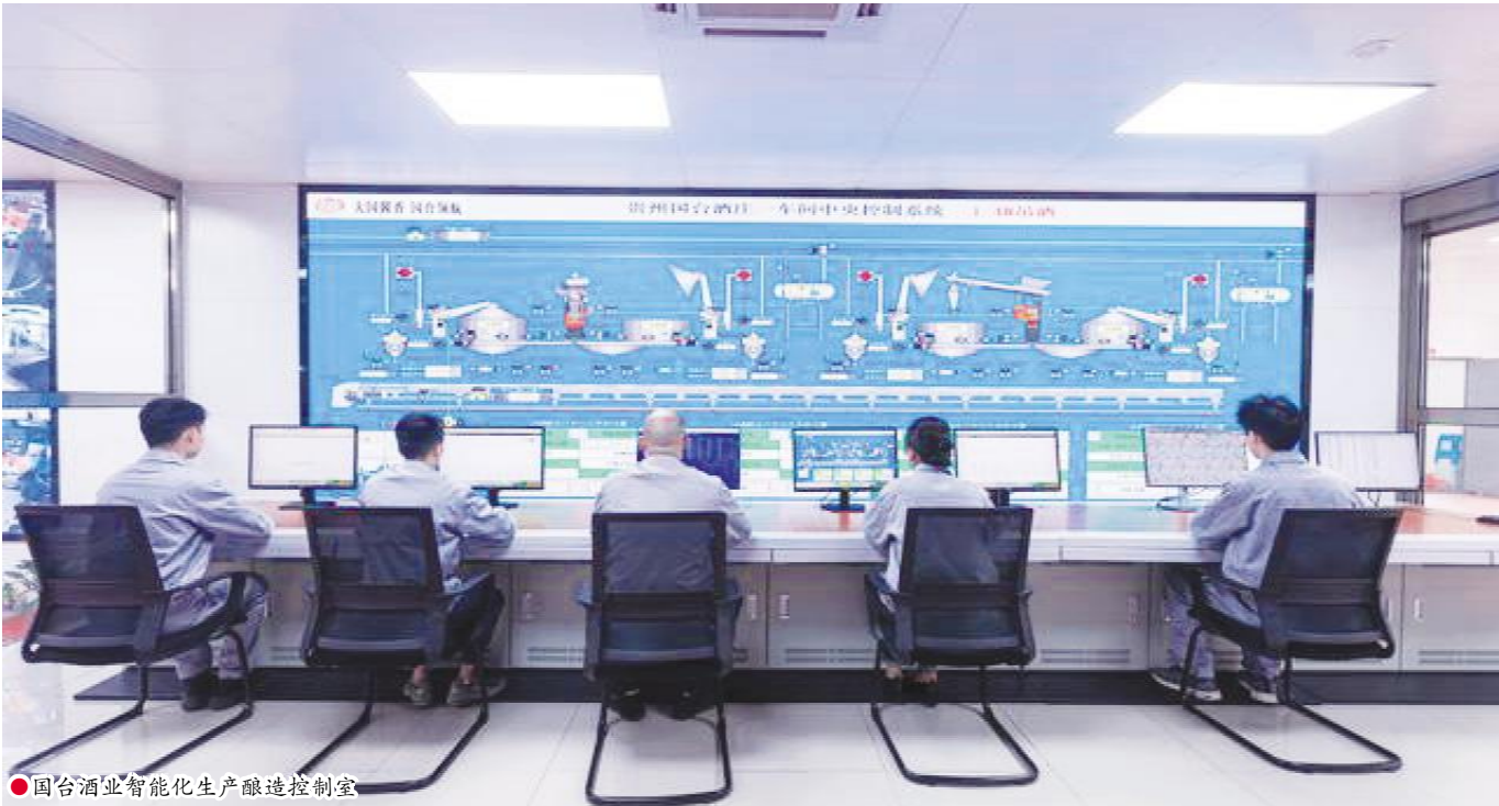
●国台酒业智能化生产酿造控制室
