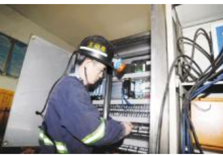
王向东检修101皮带减速机控制器。
