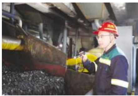
郭锋涛检查筛煤机运转情况。
