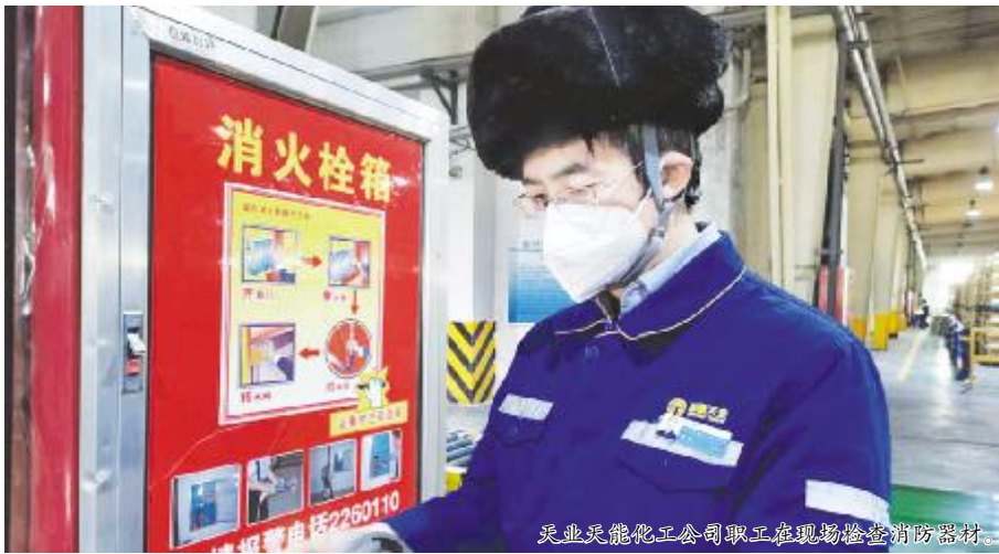
天业天能化工公司职工在现场检查消防器材
