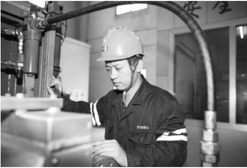
●机电维修工王鹏在副井绞车房检查设备安全运行情况。
