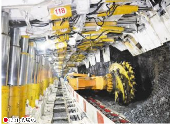
●李楼煤业采煤工作面
