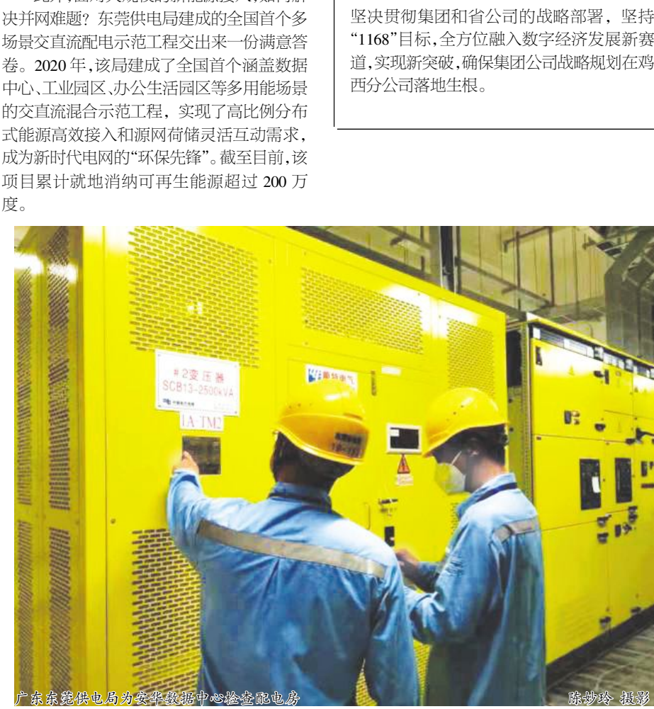
广东东莞供电局为安华数据中心配套配电房
