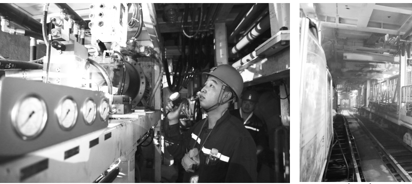
●工作人员检查首台TBM主泵站运行情况
