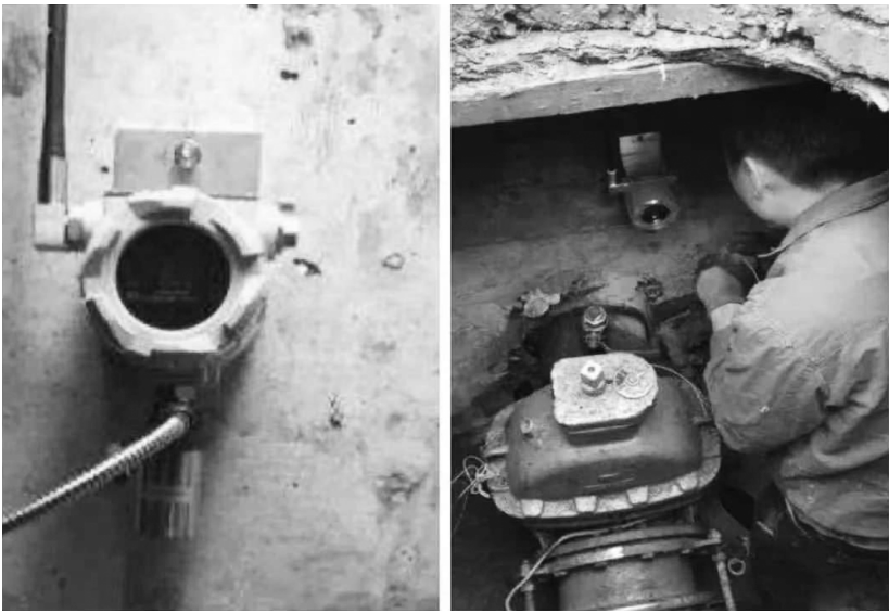
航天科工 203 号燃气监测设备助力城市燃气管网安全运行
