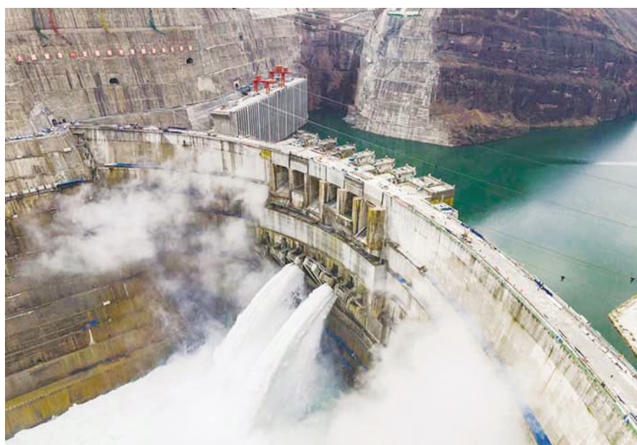
●5月31日拍摄的建设中的白鹤滩水电站(无人机照片)。新华社记者 王冠森 摄
