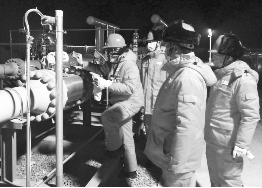
●图为2月11日，除夕之夜，鹿泉区分输清管站夜班巡检检超声波流量计数据。
