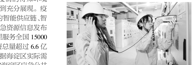
●8月10日,国网成都供电公司运维值班人员通过超声波测试仪,监测设备内部是否出现局部放电。
